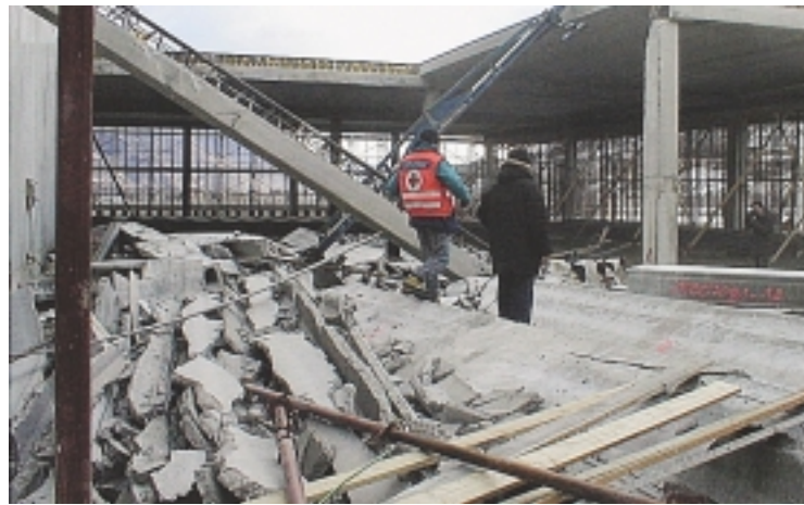
Il tetto crollato nel cantiere di Lagundo: poteva essere una tragedia
